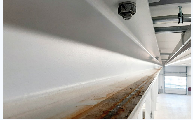
Lauffläche Kranbahn-Träger mit Verschmutzungen und leichter Korrosion.
