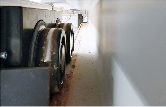
Lauffrollen der Brücke sowie Lauffläche Kranbahn-Träger mit Verschmutzungen und leichter Korrosion.
