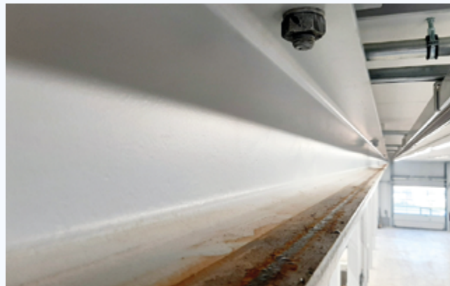
Surface de roulement du support de voie de roulement de grue présentant des salissures et une légère corrosion.
