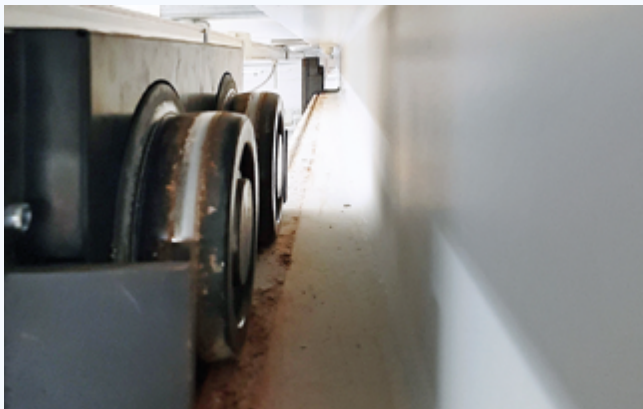
Galets de roulement du pont ainsi que surface de roulement du support de la voie de roulement du pont présentant des salissures et une légère corrosion.
