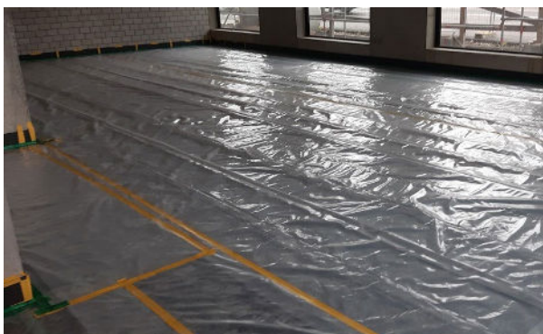
Das Schalldämmmaterial wird geschützt mit 2 Lagern PE-Folie. Die Stösse werden Bojakendicht (Zementmilch) verklebt.
