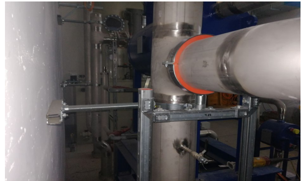
Beispiel von einem Anschluss zur Anlage mit einem weichen Kompensator/Vibrationsabsorber und zur Stahlkonsole hin eine hochwertige körperschalldämmende Rohrschelle Typ ISOSCHELL
