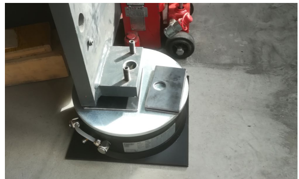
Die Luftfederisolatoren ISOAIR mit runden Lastverteilerplatten wurden unter den Maschinenfüßen montiert und die richtige Höhe mit Schiffplatten aus Stahl einjustiert
