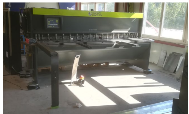
Nach Abschluss der Montage war die Tafelschere elastisch mit ISOAIR und ISOLMER® gelagert, sodass der Testlauf durchgeführt werden konnte
