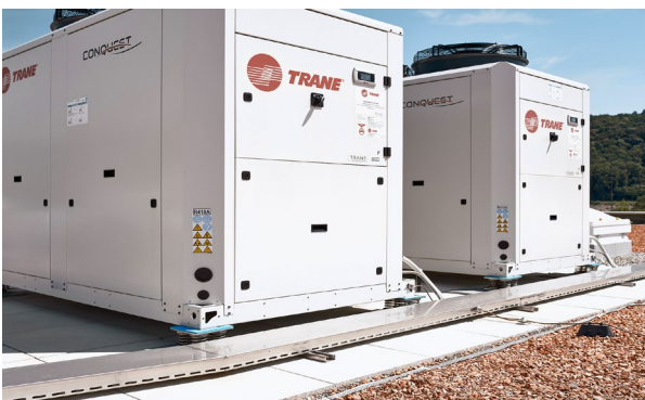
Fertig gelagerte Kältemaschinen. Aufgrund des hohen Eigengewichts ist keine zusätzliche Windsicherung notwendig.
