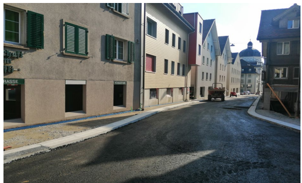
Sicht auf das Objekt und die umgebende Strasse vor dem Einbau des Endbelages
