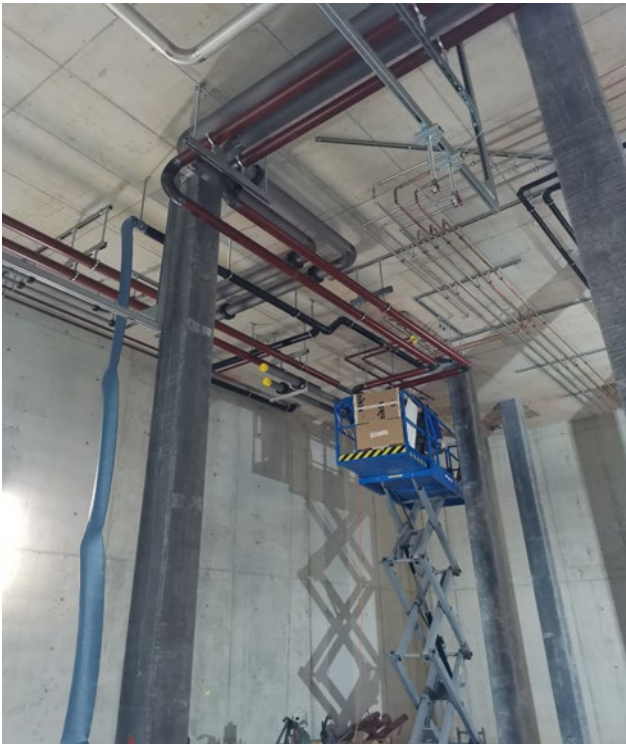
Die Montage der Rohre und der ISOROHR® erfolgte Zug in Zug mittels Leitern oder spezieller Lifte
