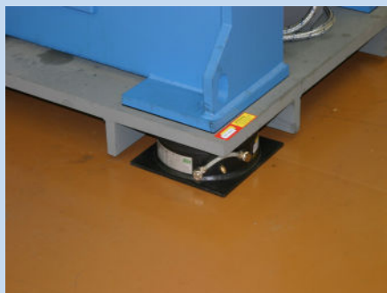
Detail der Lagerung mit Maschinengrundplatte und ISOAIR
