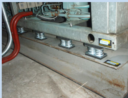
Kälteanlage auf Stahldruckfedern Typ ISOLASTIC gelagert
