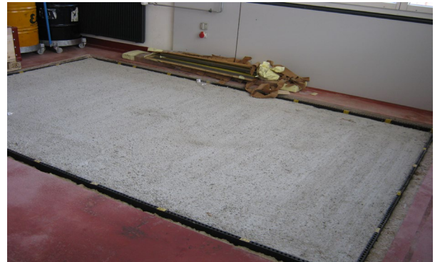
Fertig betonierte Fundamentplatte mit der umlaufenden vertikalen Trennung durch Elastomerlochplatten des Typs ISOPLAT
