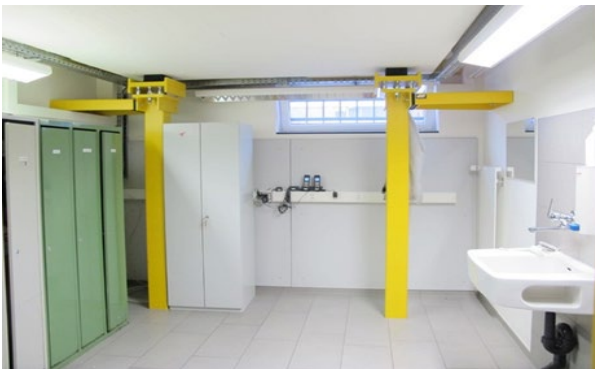
Stützen im Raum unterhalb der Maschine mit den Elastomerlagern im Kopfbereich
