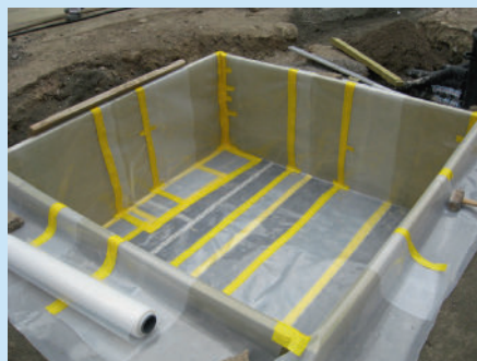
Zone inférieure d'ascenseur revêtue d'une couche protectrice
