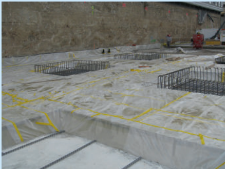
Revêtement posé terminé dans les zones des surfaces et des fondations du 2 e sous-sol
