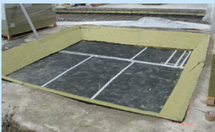
Revêtement horizontal en élastomère de type ISOPOL-HT-15 posé en 2 couches dans la zone des fondations
