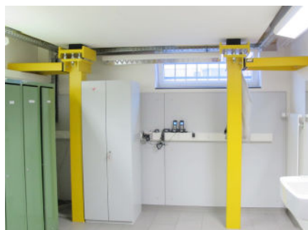
Local au-dessous de la machine avec le socle porté par des piliers acier. En tête des piliers, les appuis élastomères ISOBLOCK.
