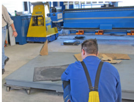
Alignement du socle en acier. Au fond, sous la machine, on aperçoit les éléments amortisseurs ISOAIR.
