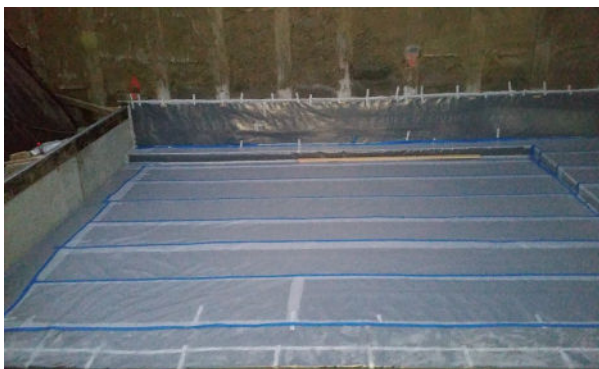
Die gesamte Lagerung wurde mittels zwei Lagen zäher, dicht verklebter PE-Folie abgedichtet und so gegen das Eindringen von Betonbojake geschützt.
