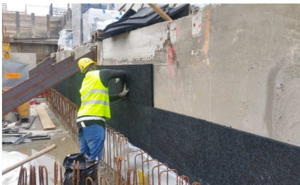
Montage der vertikalen Elastomerkormmatten ISOPOL® im Bereich der Betonwand gegen die Bahnlinie.
