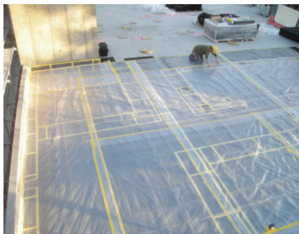
L'appui en ISOPOL est recouvert de feuilles de PE. Les raccords se recouvrent et sont soigneusement collés.
