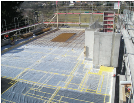
Un appui isolant contre les bruits solidiens entre la dalle du garage et celle de l'habitation apporte la protection voulue.
