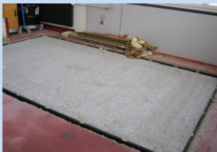
La dalle de fondation bétonnée, avec son joint de séparation du pourtour en plaques élastomères perforées du type ISOPLAT
