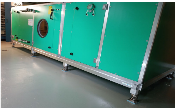
Fertig gelagerte Anlage
