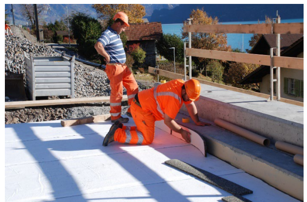
Vollflächiges Ankleben der vertikalen Seitenmatten. Die Stösse der Seitenmatten werden – analog der horizontalen Matten mit dem Abdeckband verbunden.
