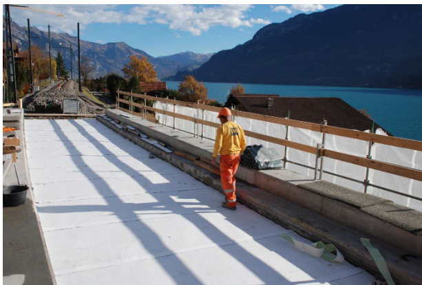
Die Unterschottermatten in der horizontalen sind fertig verlegt und die Mattenstösse mit einem schutzvlies-kaschierten Abdeckband von sehr hoher Klebkraft verbunden.
