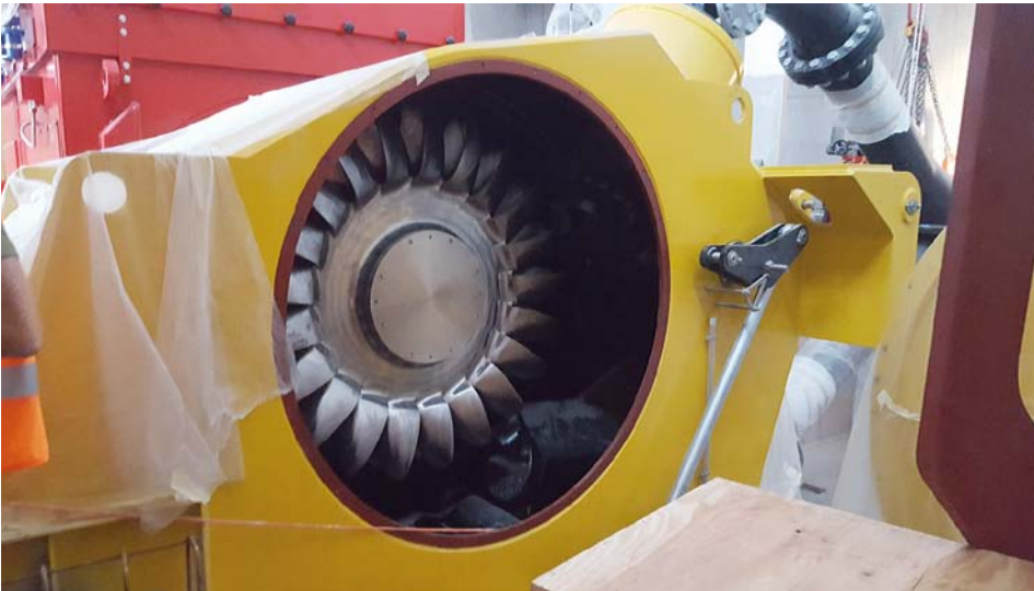
Abb. 4: Blick in die neue Pelton-Turbine
