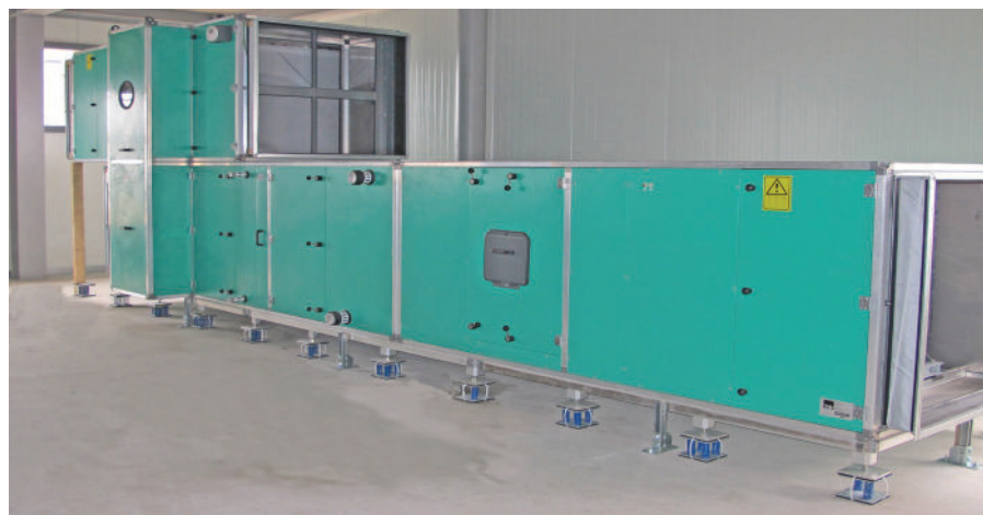
Die 60 Monoblock-Anlagen wurden über total 530 Federpakete ISOFED und ISOROHR schwingungsdämmend gelagert.
