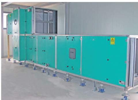
Die 60 Monoblock-Anlagen wurden über total 530 Federpakete ISO FED und ISOROHR schwingungsdämmend gelagert.
