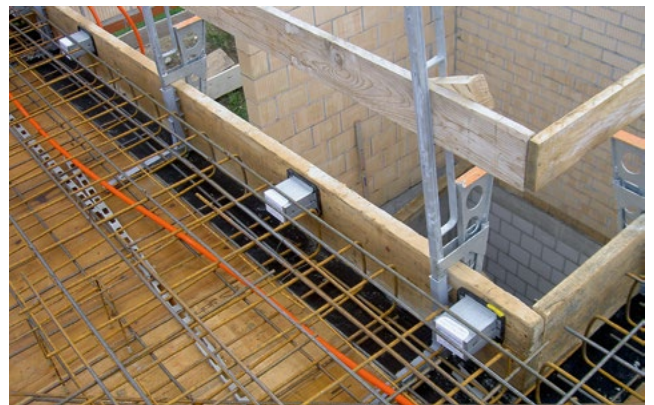
Bétonnage sur place: Les boîtiers isolants acoustiques ISOLA® 35 dB sont montés dans la bonne direction dans le coffrage du noyau de la cage d'escalier, prêts à être bétonnés dans la dalle.
