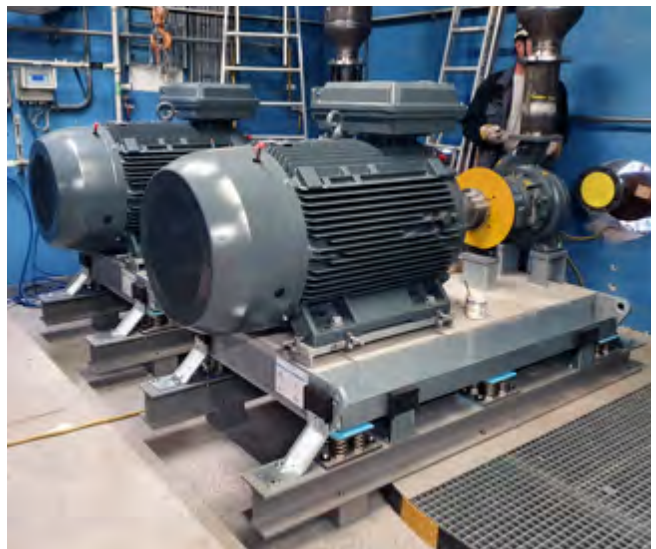
Umwälzpumpen und Kühlgeräte
