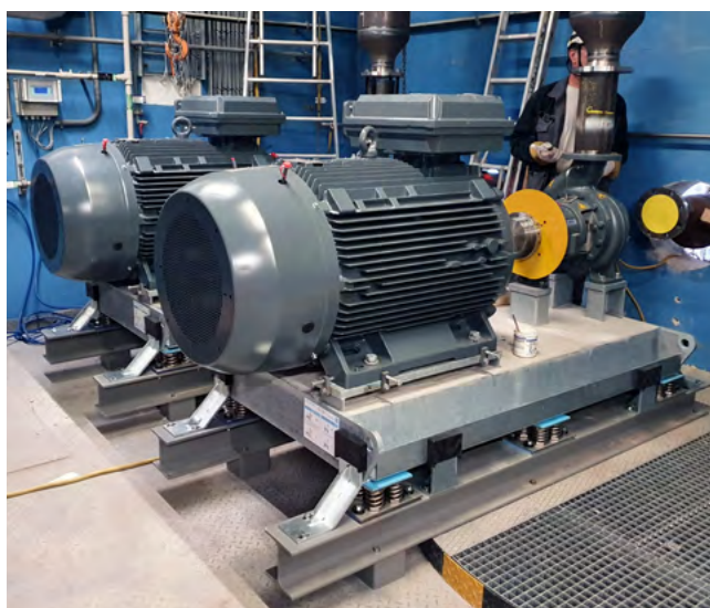
Pompes de circulation et appareils de refroidissement
