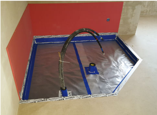
Eck-Wanne: fertig montierte Lagerung mit schallweicher Trennung zur Decke, Wänden und Leitungen
