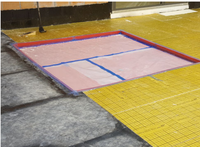
Aussenpool: auf der Abdichtung der Terrasse montierte Lagerung, vor dem Einpassen der thermischen Dämmung und dem Betonieren des Massefundamentes
