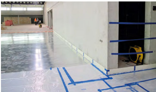
Protection complète de la surface d'appui avec 2 couches de feuilles PE collées de manière étanche au laitier de ciment
