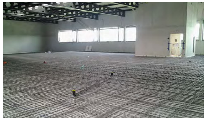
Pose de l'armature et bétonnage de la dalle de répartition des charges, contrôle de la qualité par HBT-ISOL
