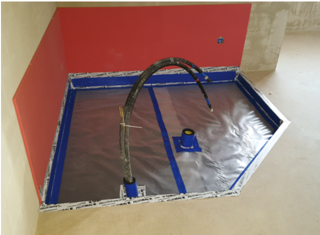
Baignoire à angle: isolation acoustique posée avec séparation souple contre dalle, parois et conduites
