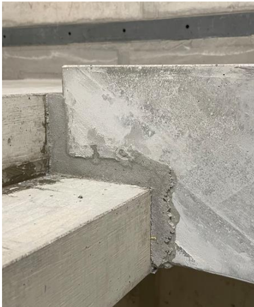
Abbildung 9: Starre Verbindung zwischen Treppenlauf und Podest
